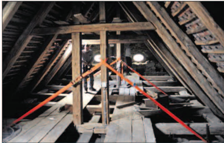
Die Spanngurte im Dachstuhl von St. Sebastian sind nur ein Provisorium. Die Risse im Mauerwerk wachsen weiter. Bild: For
